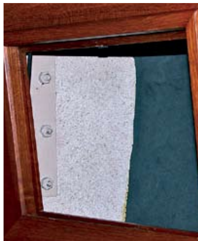
Die Riggkräfte werden zuverlässig aufgefangen, im Bild ein Unterwarpfütting
