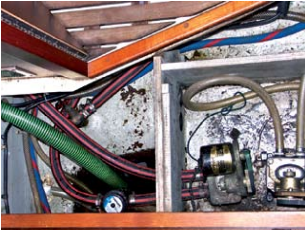
Ein tiefer Sumpf verhindert, dass Wasser unkontrolliert im ganzen Schiff herumschwappt. Die übrige Bilge kann zum Stauen der Vorräte genutzt werden
