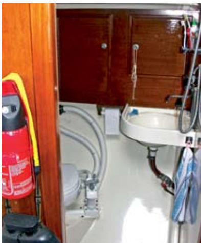
Der Sanitärraum ist üppig ausgefallen, fließend warmes und kaltes Wasser ermöglicht entspanntes Duschen
